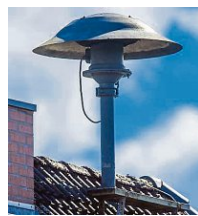
Von ihnen soll es auch in Gilching bald einige mehr geben: eine Sirene auf einem Hausdach.
